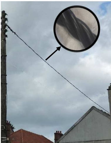
Réseau fils isolés aérien BT
